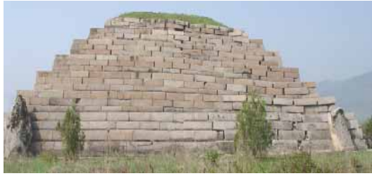
图 1 将军坟东北侧面沉陷倾斜、追踪张裂图
